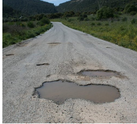
Şekil 1. Karayollarında tuzun etkisiyle hasara uğramış bir yol
